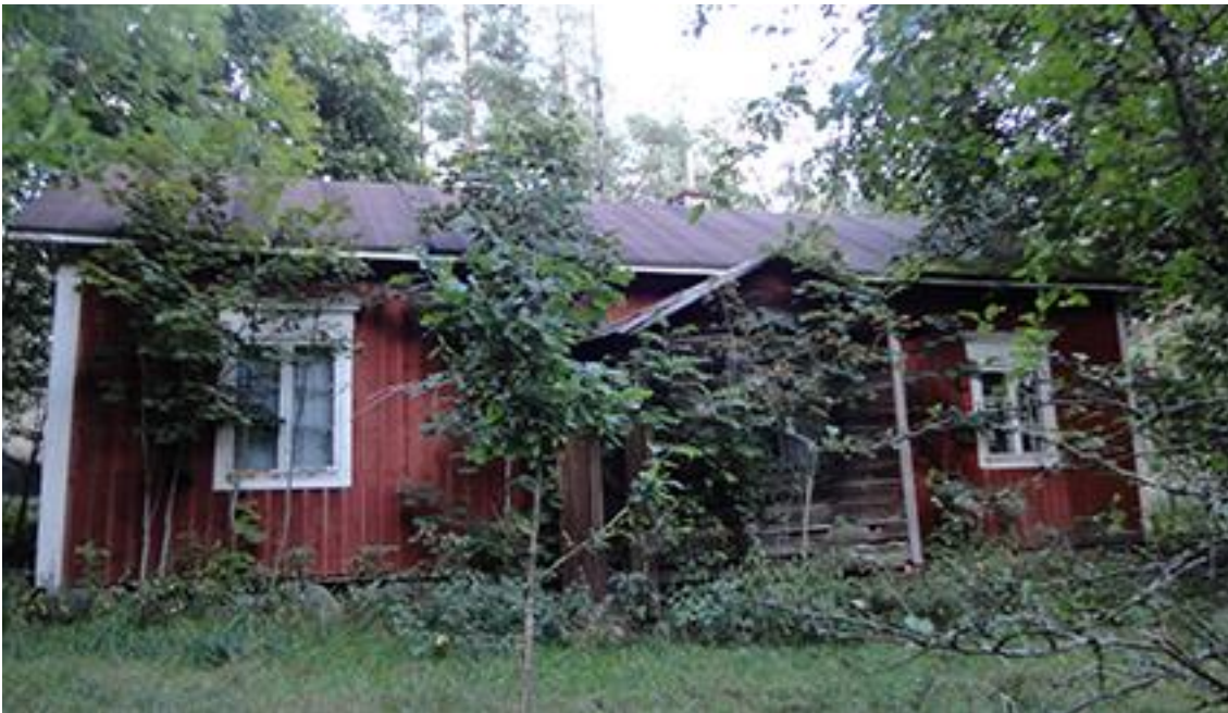
Gårdens gamla huvudbyggnad. Farstun och baksidans tak, som störtat in gör att det är fråga värt om huset längre går att reparera.
