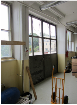
Rautaovet ovat 1950-luvun lopulta, mutta lasipinnat on sittemmin jouduttu vaihtamaan rakenteellisten ongelmien vuoksi.
