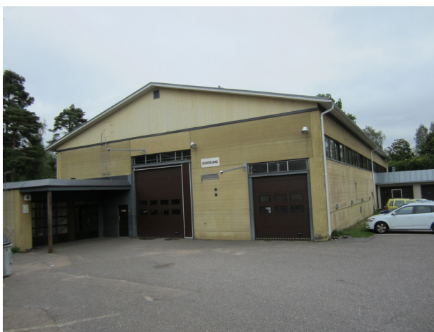
Auto- ja kuljetusosaston rakennus kuvattuna lounaasta kesällä 2012. Rakennuksen tasakatto korvattiin harjakatolla vuonna 2002.
