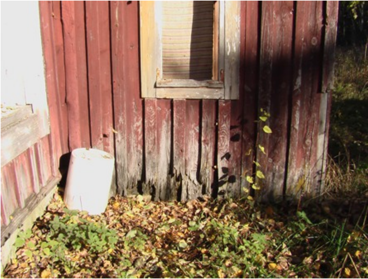
De konstruktioner som har varit i kontakt med marken är förstörda. Maakontaktissa olevat rakenteet ovat pilaantuneita.
