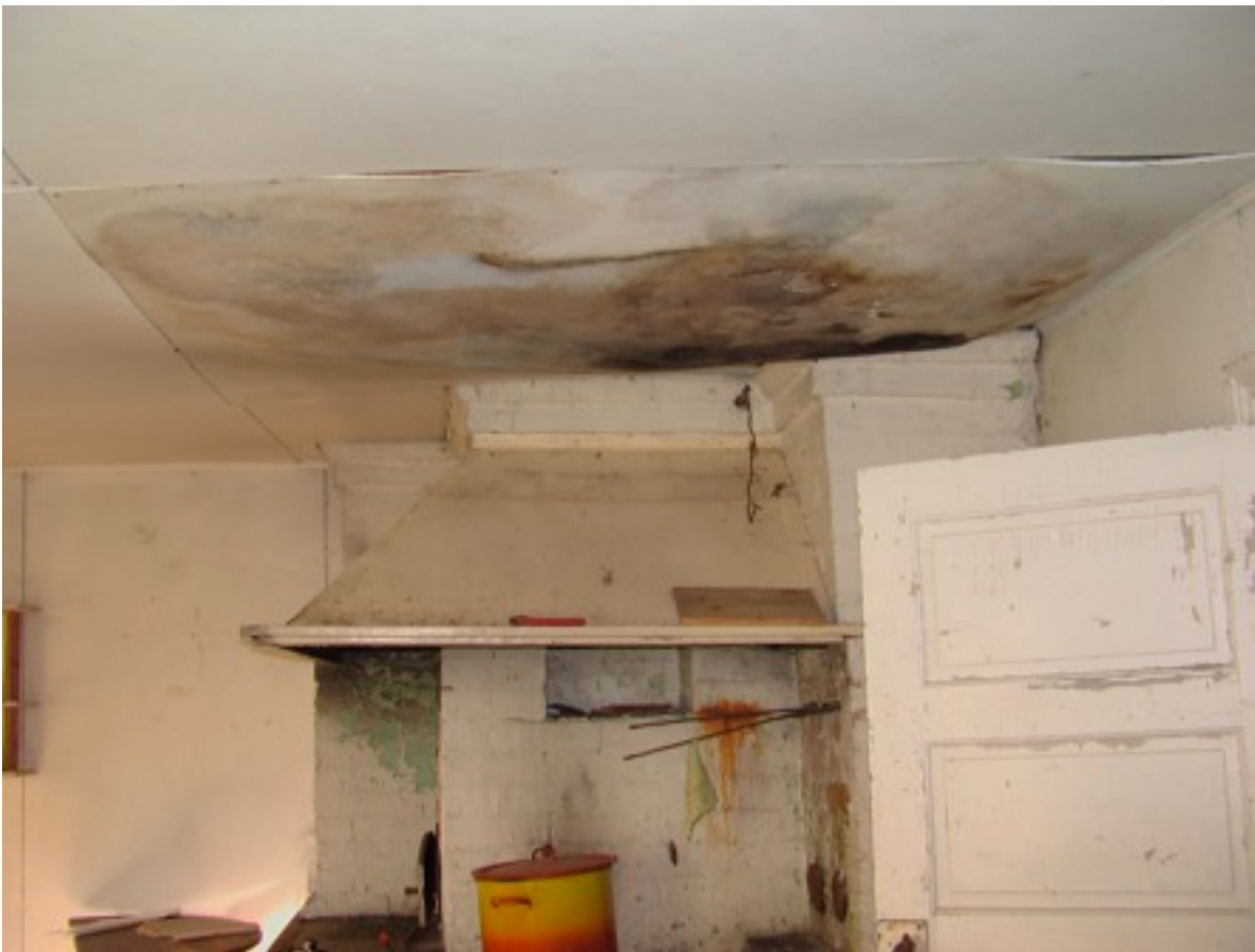
Innertaket är skadat. Vahingoittunutta yläpohjaa.
