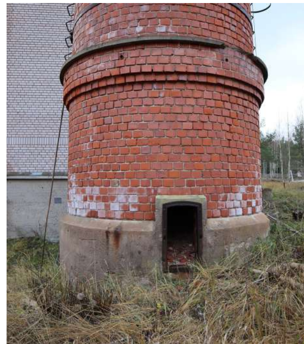
Savupiipun alaosan puhdistusluukku on hävinnyt.
