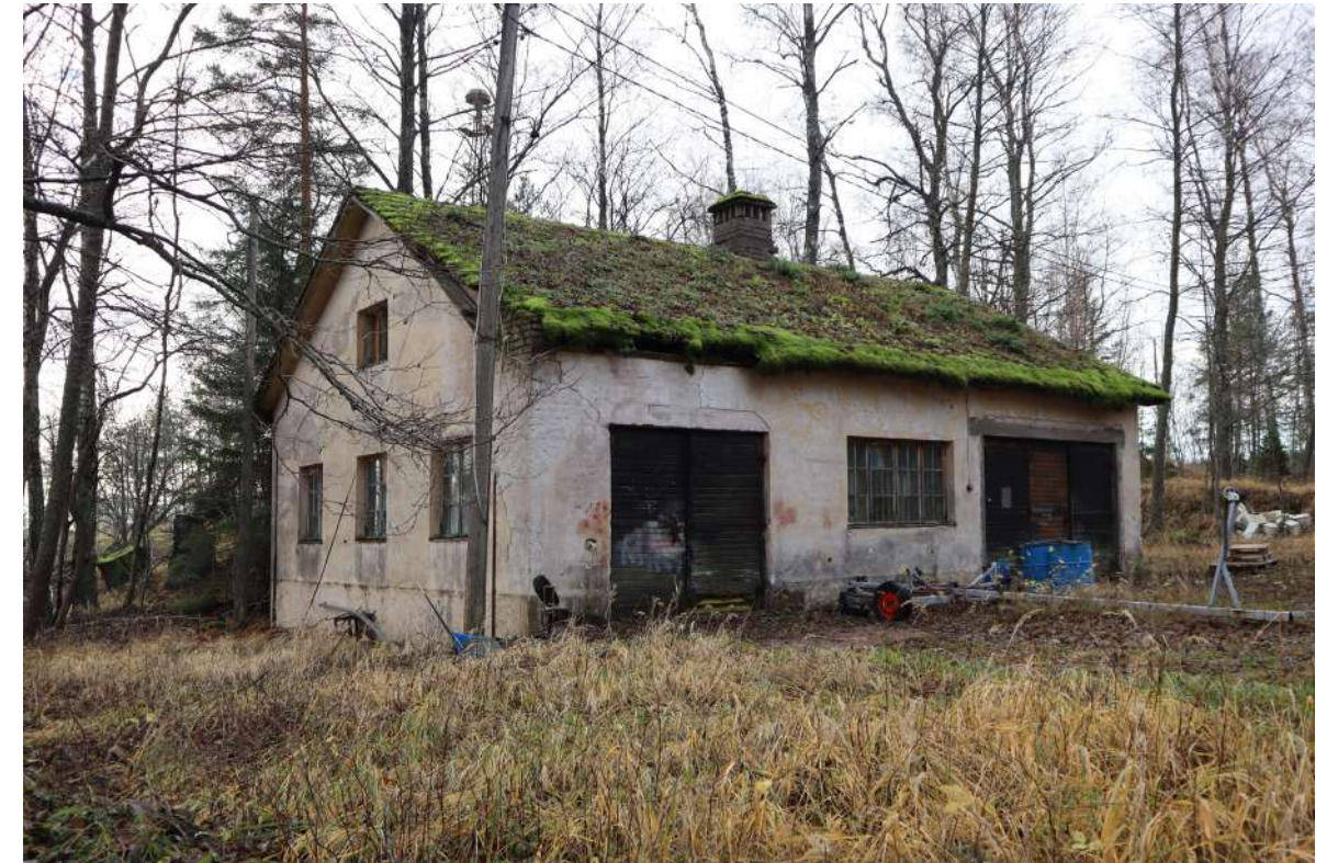
Pariovin varustetut sisäänkäynnit sijoittuvat pohjoissivulle, kattoa peittää paksu sammalkerros ja ainakin päädyn räystäslaudat ovat vaurioituneet.
