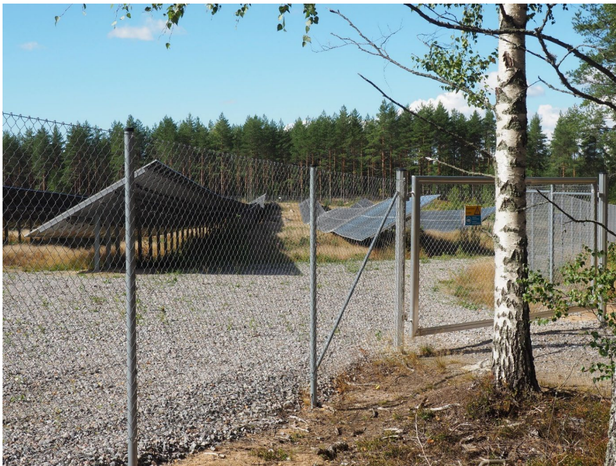
Kuva3. Alueelle on jo rakennettu noin 1500m aurinkopaneeleita yhdeksään riviin.
