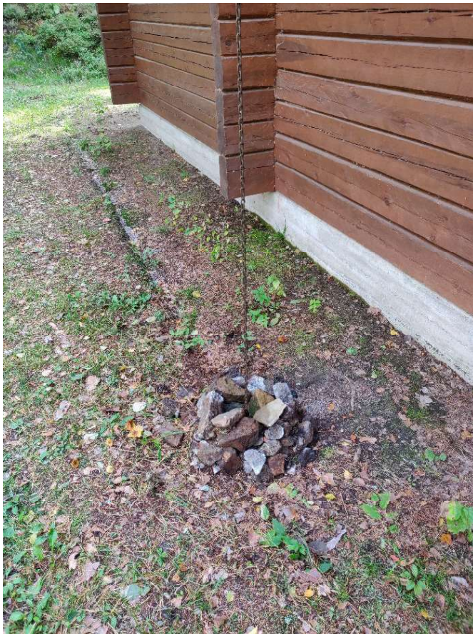
KUVA 41 Kuvattu vuonna 2019, ennen vuoden 2020 räystäskouru- ja syöksytoviremonttia: pääoven vasemmalla puolella ollut sadevesiketju.
