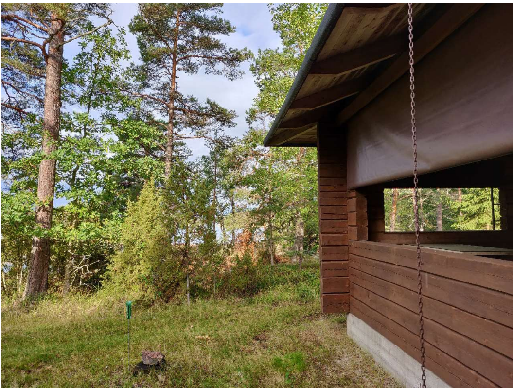
KUVA 39 Saunan terassin kulma ja näkymä länteen. Kuvattu vuonna 2019, ennen vuoden 2020 räystäskouru- ja syöksytoviremonttia.
