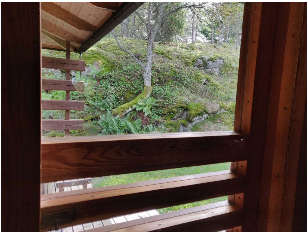
KUVA 65 Näkymä keittiön ovelta itäiselle terassille ja taustalla kallioalue. Kuvattu vuonna 2019, ennen vuoden 2020 räystäskouru- ja syöksyturviremonttia.
