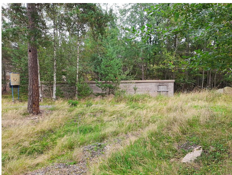
Den tidigare vattencisternsbunkern är även den i rivningsskick.
