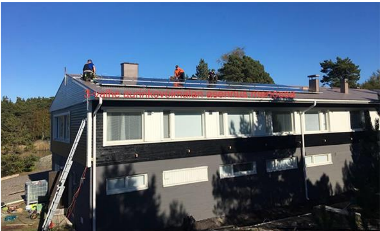
I byggnaden installerades ett 7 kW:s solpanelsystem. Som uppvärmningssystem installerades värmeaggregat med bergsvärme bestående av tre 200 meter djupa borrhål (inte på bild).
