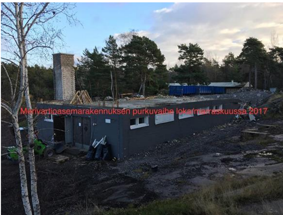
Saneringsprojektet inleddes med att riva stationsbyggnaden och avlägsna den bakom liggande oljecisternen.
