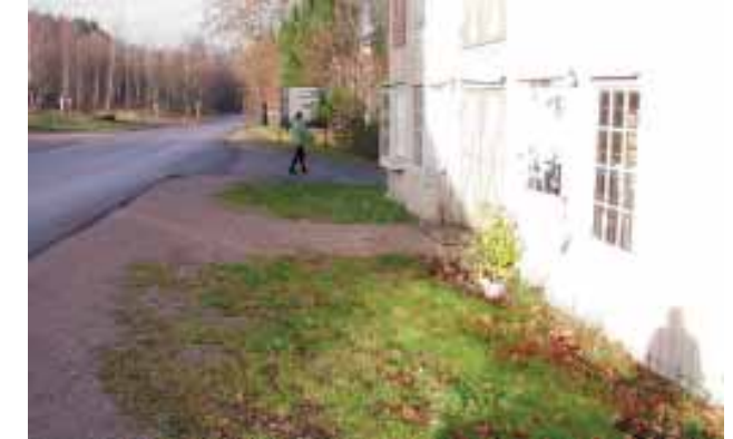
Tien pinnan nousu haittaa rakennusta.
