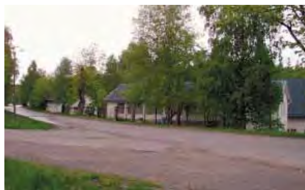
Tie on noussut niin korkealle, että rakennus kärsii tiealueen lumivalleista ja valumavesistä. Tien puoleinen myöhemmin rakennettu lisäsiipi vaikeuttaa toimivan vedenpoistojärjestelmän luomista.
